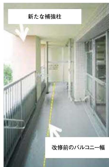
<H25改正により耐震改修計画の認定対象になる改修工法の例>
